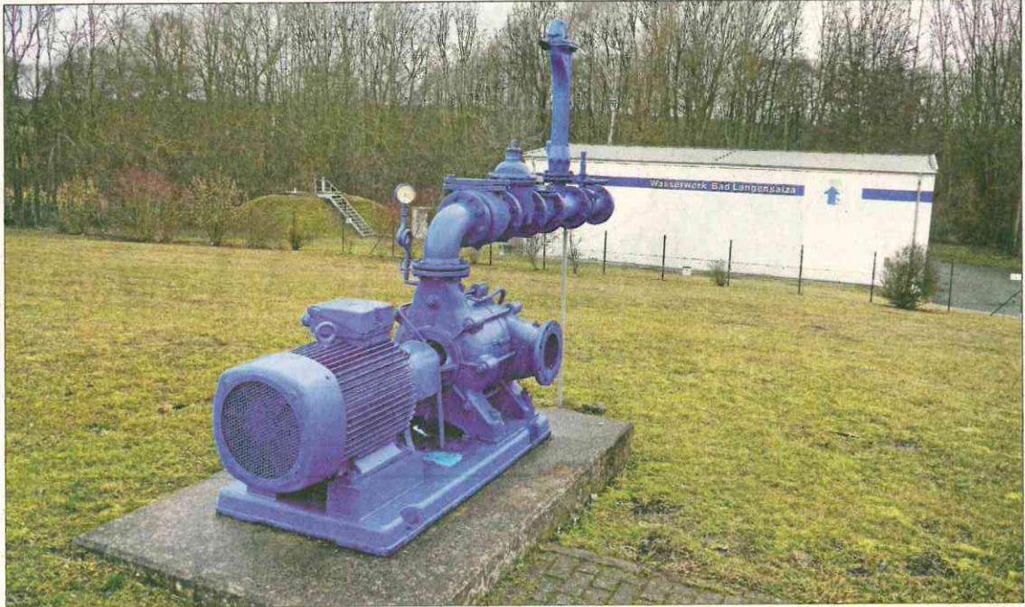
Das Wasserwerk am Golken in Bad Langensalza wird mit dem Anschluss der Region ans Fernwassernetz 2022 eigentlich nicht mehr benötigt. Es soll dennoch im Minimalbetrieb weiterlaufen, auch um für Notfälle gewappnet zu sein.
